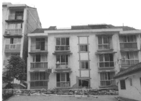
(a) 某框架首层完全垮塌
