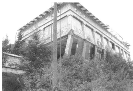
(b) 北川某框架二层柱铰破坏
